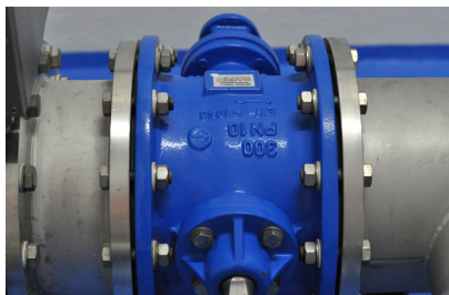
Mit Isolierhülsen aufgetrennte Gussarmatur
