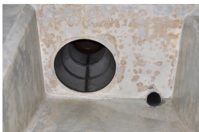
Weiche braune Flecken im Bereich von Chromstahleinbauten
