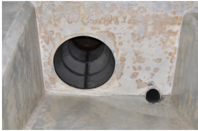
Weiche braune Flecken im Bereich von Chromstahleinbauten
