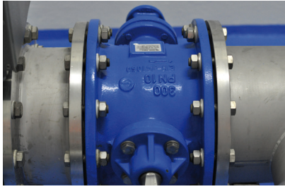
Mit Isolierhülsen aufgetrennte Gussarmatur
