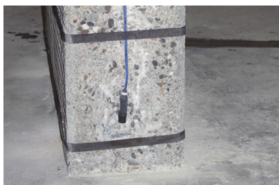
Anodes montées et une électrode de référence sur un pied de poteau
